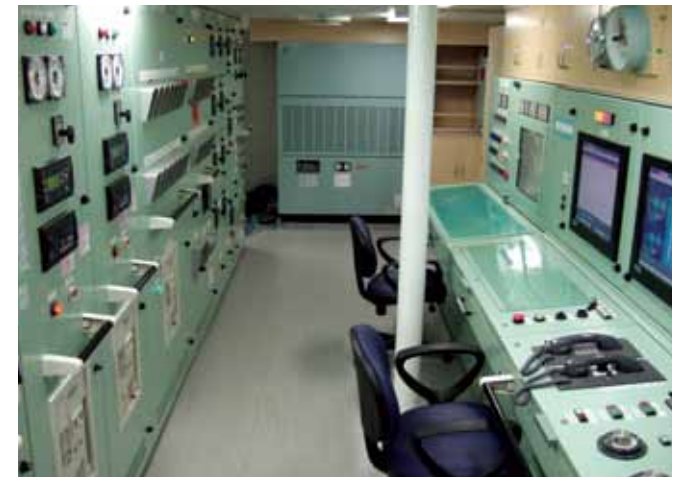
機関制御室 ENGINE CONTROL ROOM
