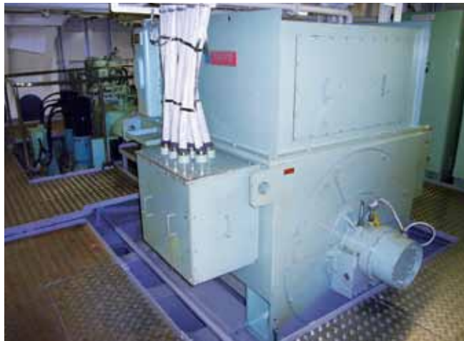
推進電動機 PROPULSION MOTOR
