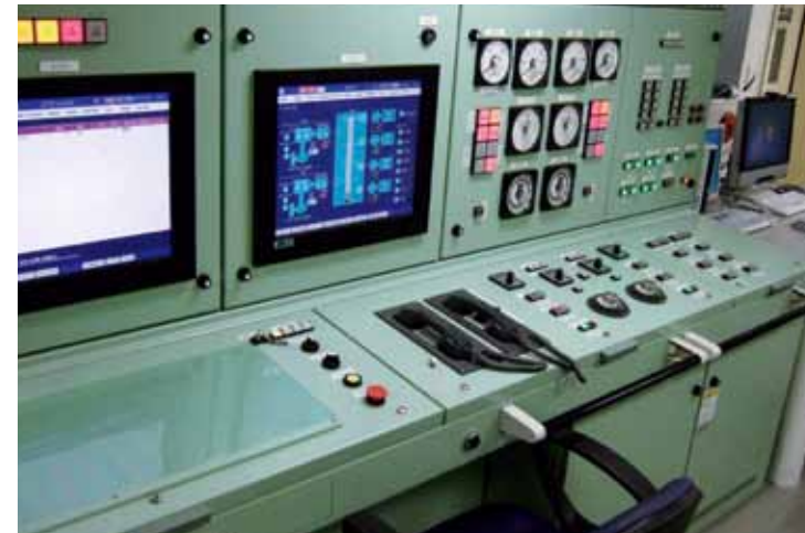
機関管制室 機関制御盤 (ECC) ECC IN ENGINE CONTROL ROOM
