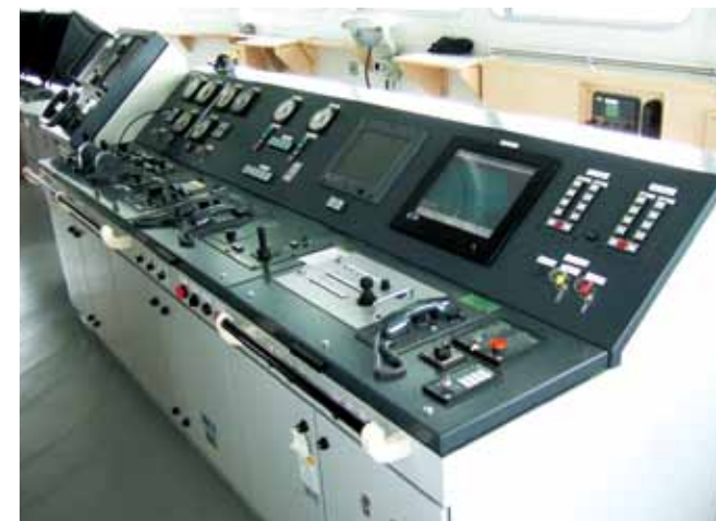
機関制御区画 MACHINERY CONTROL SPACE
