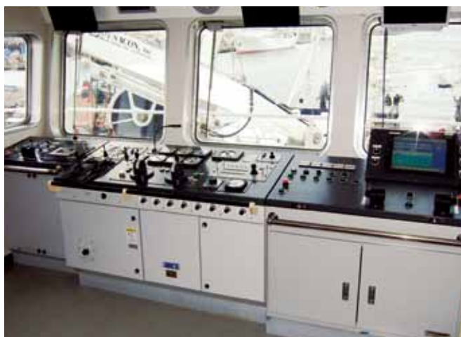
ウインチ制御区画 WINCH CONTROL SPACE
