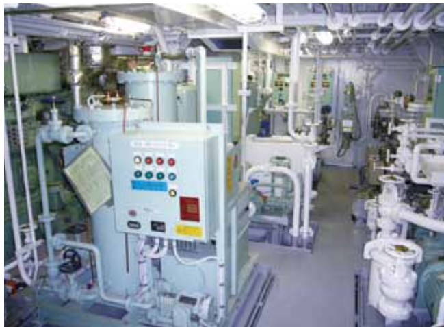
機関室 ENGINE ROOM
