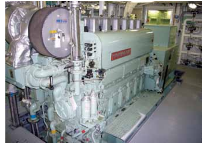
主発電機関 MAIN GENERATOR ENGINE
