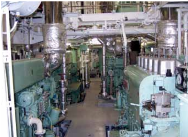
機関室 ENGINE ROOM
