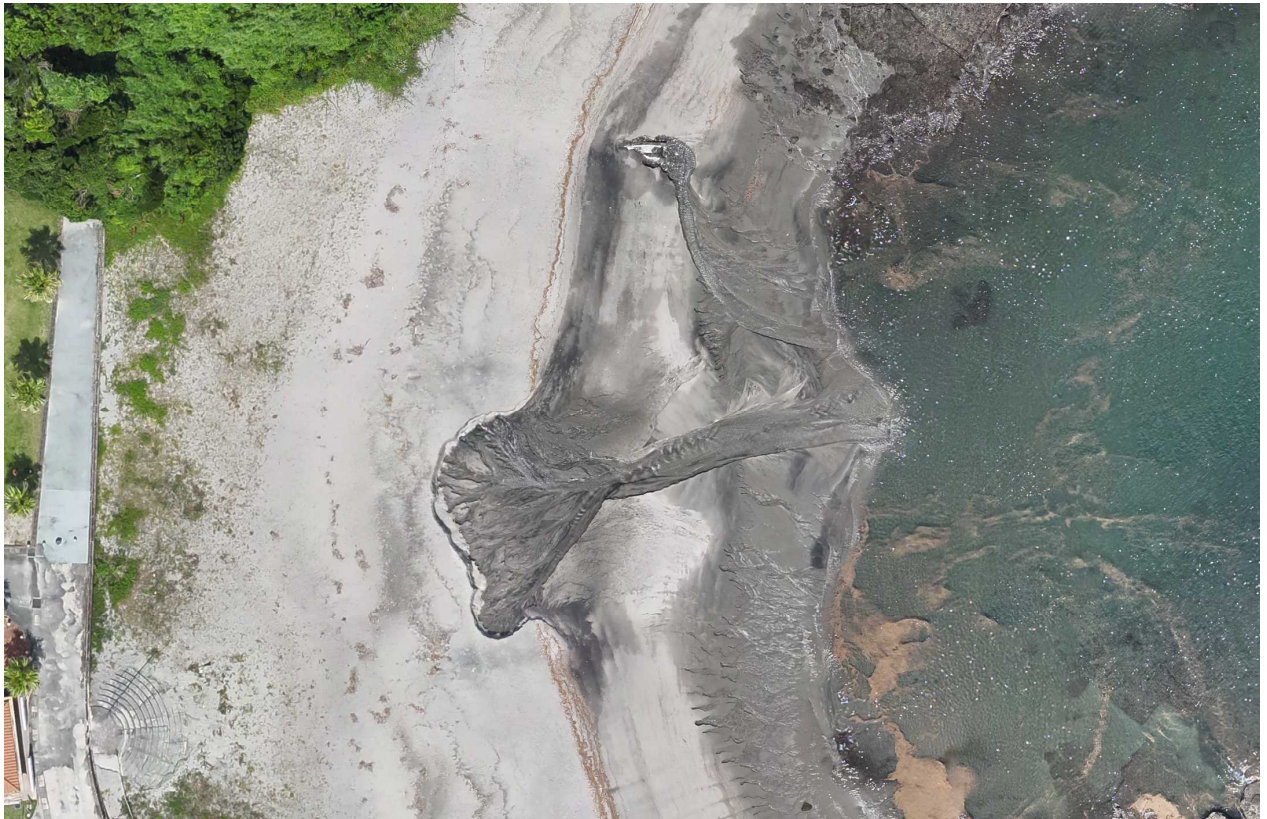
写真-1.7 地下水の湧水による前浜の侵食状況
