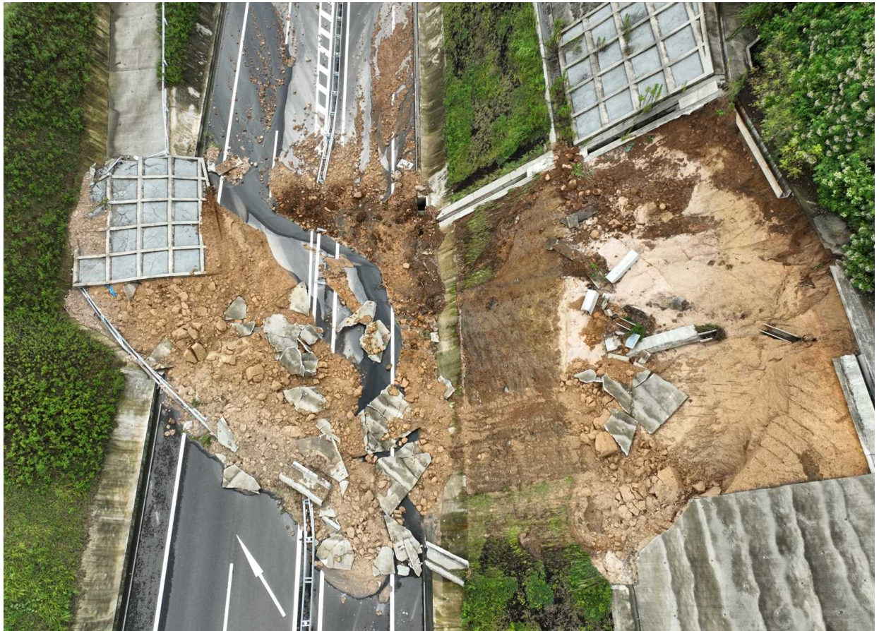
写真-1.2 豪雨災害後の法面崩落
