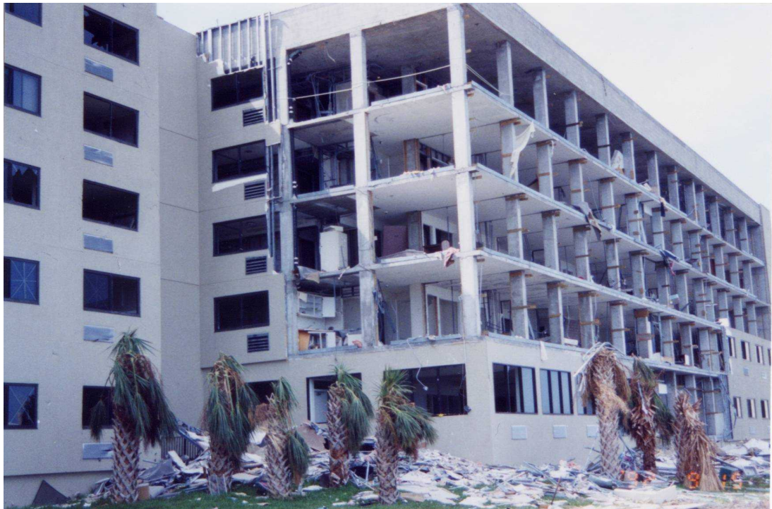
暴風により壁が吹き飛んだアパートメント
